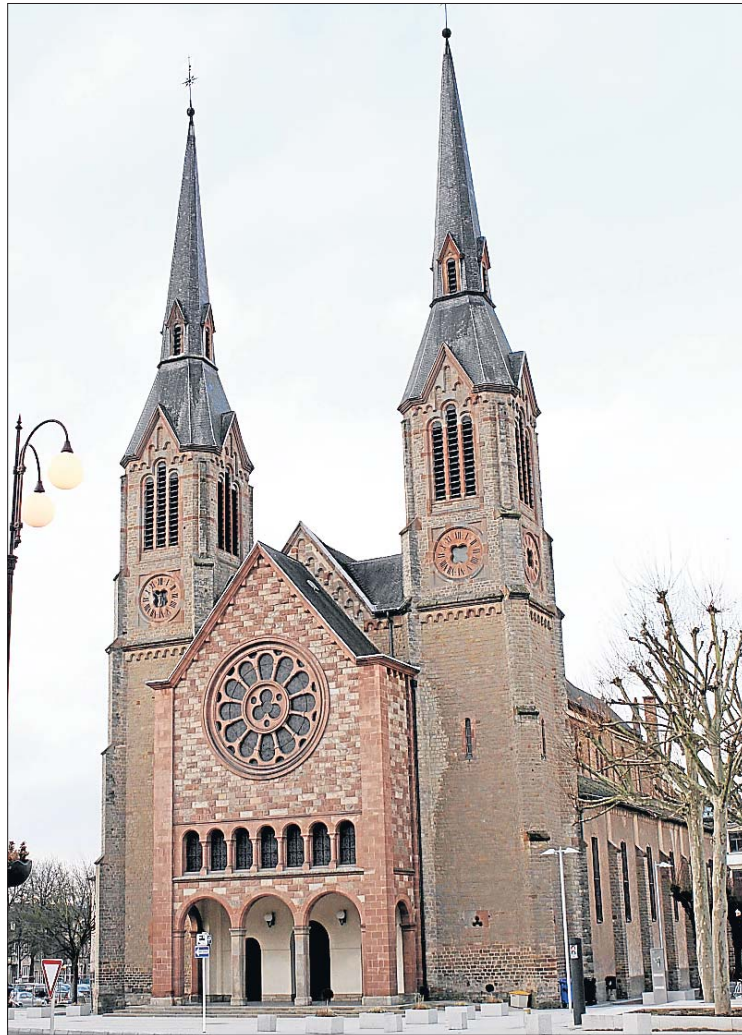
1,2 Millionen Euro werden in die Instandsetzung des Daches sowie der Fenster der Dekanatskirche fließen, derweil weitere 50 000 Euro für die Studie des Projekts „neue Orgel“ eingesetzt werden. (FOTO: ARLETTE SCHMIT)
